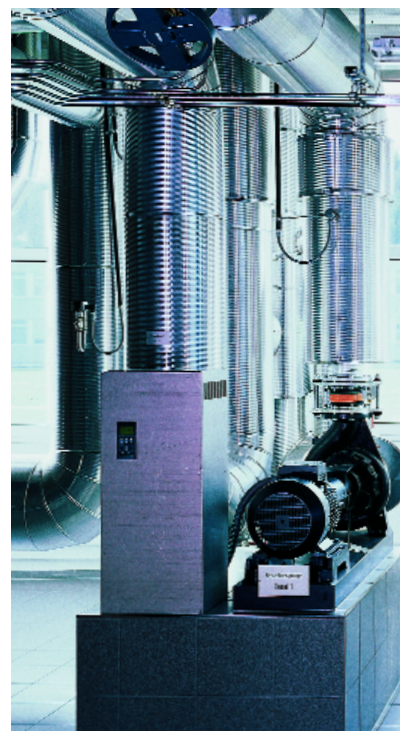
Fordulatszám-szabályozott kazánköri szivattyúk
